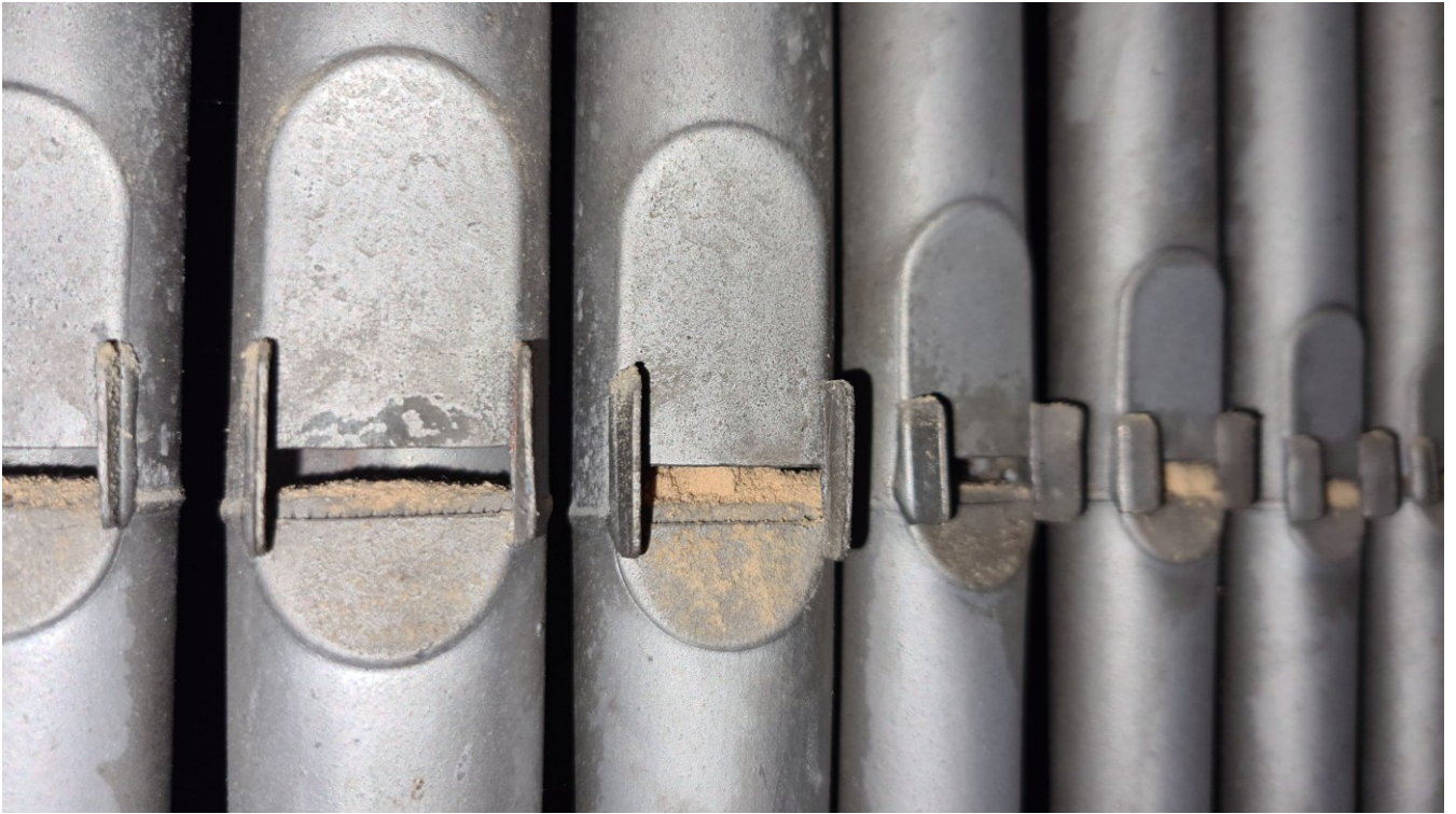
Holzwurmmehl in den Prospektpfeifen lässt auf partiell starken Befall schließen
