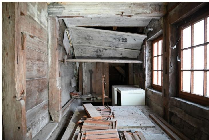
Blick auf den desolaten baulichen Stand der Bälgekammer
