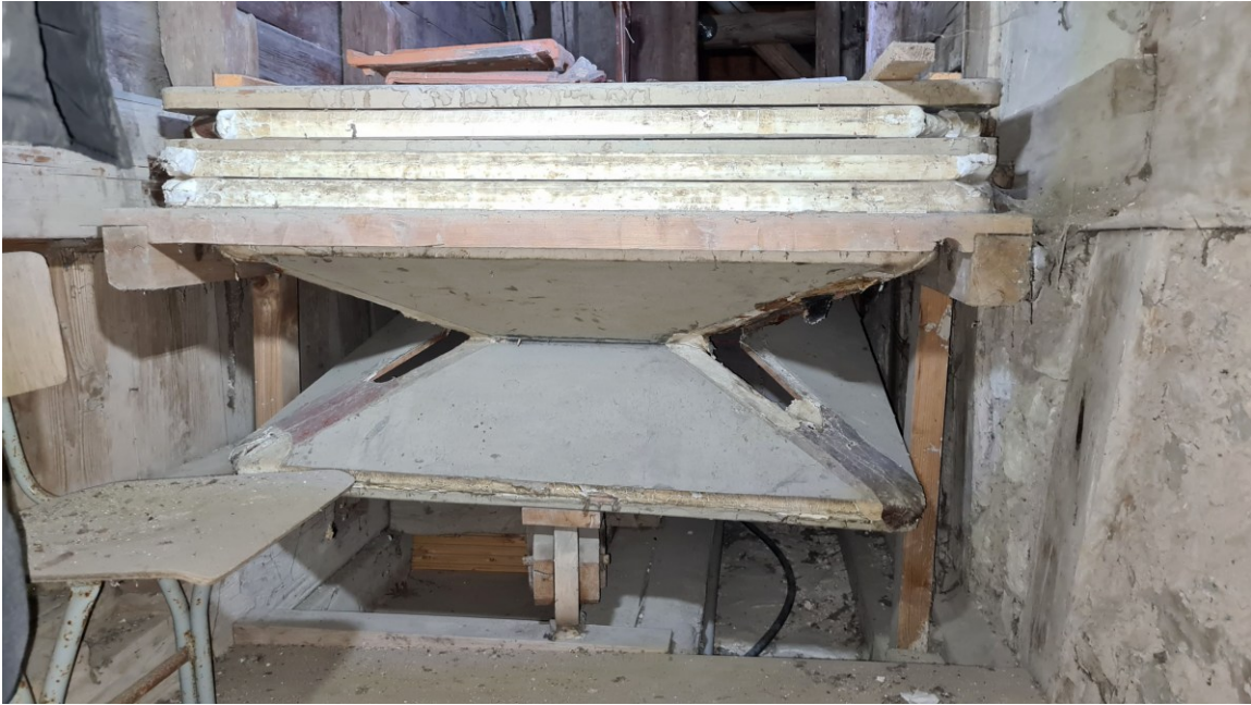
Blick auf den stark restaurierungsbedürftigen Magazinbalg
