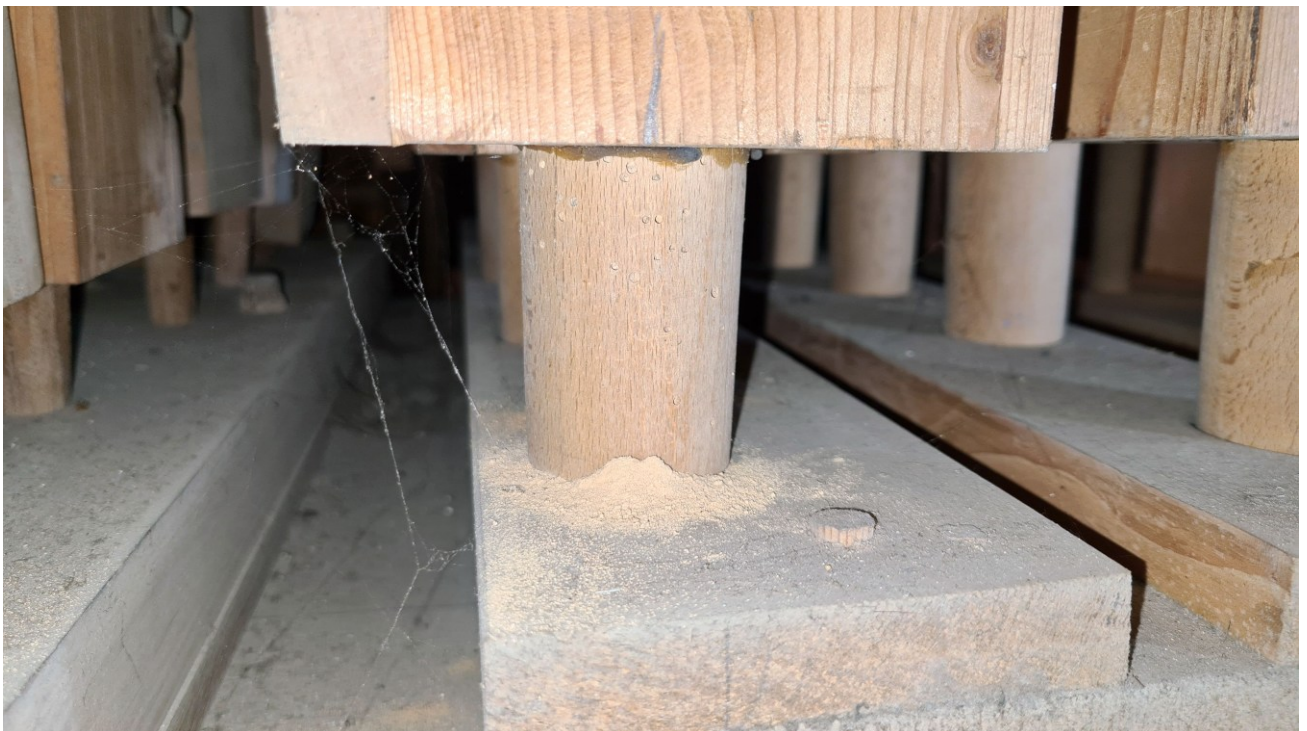
Partiell starker Holzwurmbefall im Holzpfeifenwerk
